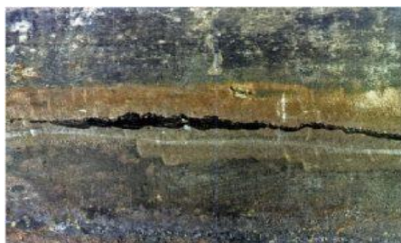
Рисунок 9 – Коррозия поверхности металла межкристаллитная
