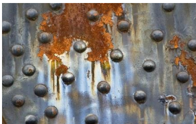
Рисунок 5 – Коррозия поверхности металла в виде пятен
